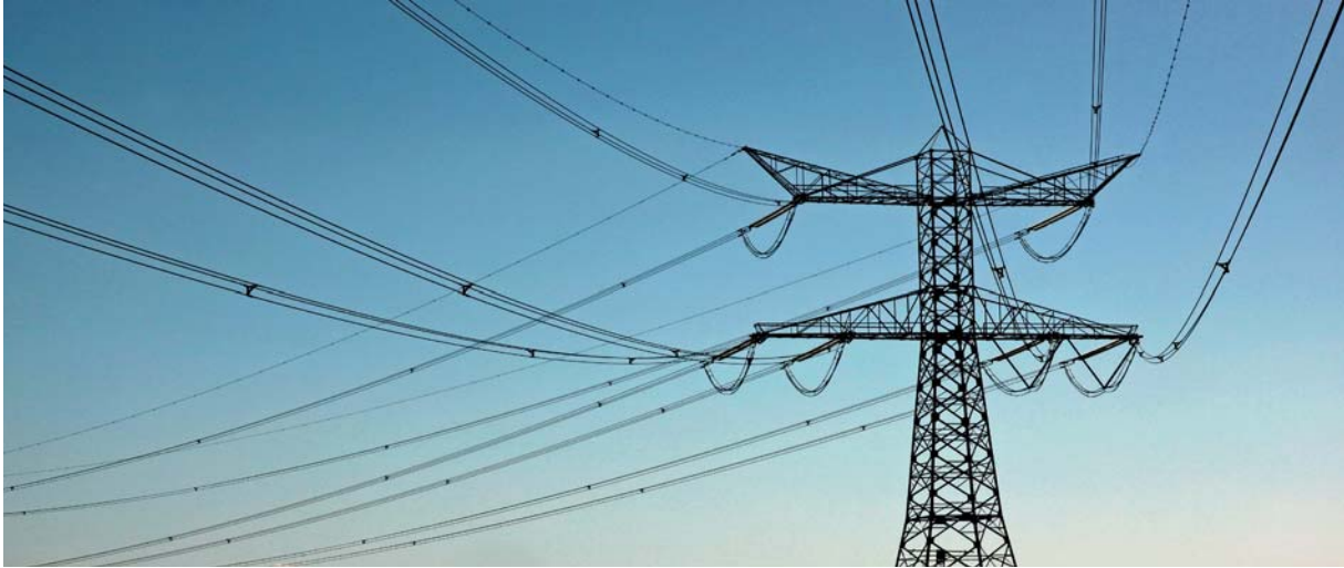
Afbeelding 4 Elektriciteitsmast (fotograaf: Edwin van Eis, 3 juni 2010)
